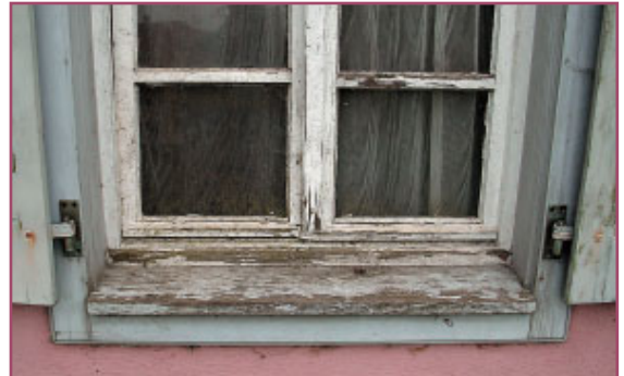
Zustand der Fenster und Sims Bretter
