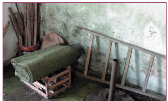
Schimmelbildung an den Wänden im Untergeschoss.
