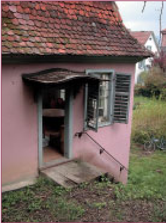
Ansicht der Südfassade nach der Befreiung von Gestrüpp und Schlingpflanzen, die bis in das Dach hineingewachsen waren.
